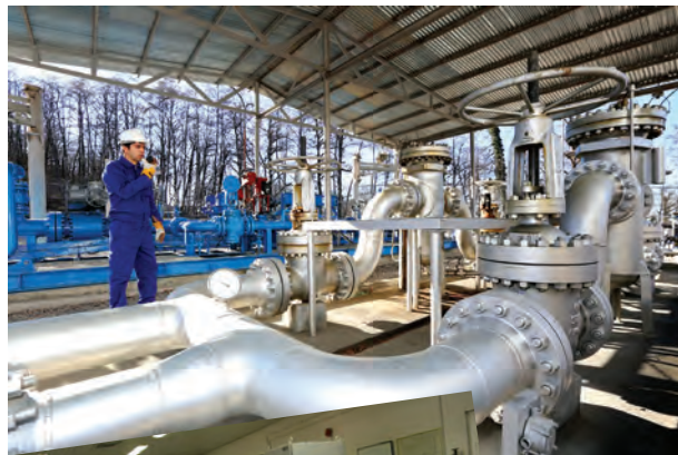
منطقه شمال - ایستگاه فشارشکن لاجیم
